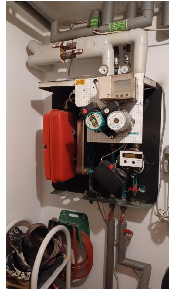
Abb: Beispiel einer Hausanschlussstation
