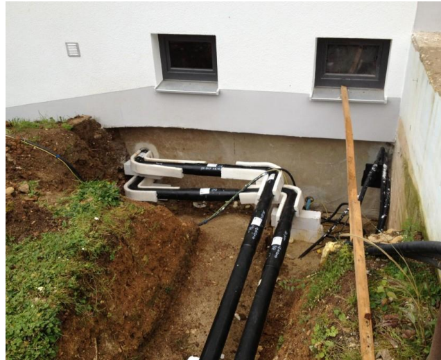
Abb: Beispiel für die Einführung des Fernwärmeanschlusses ins Gebäude
