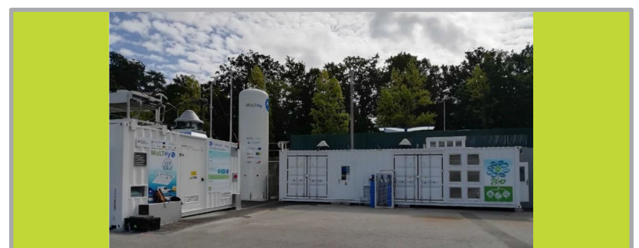
Abb. 4: Installierte Wasserstofftankstelle in Nantes (PEM-Elektrolyse links im Bild)
