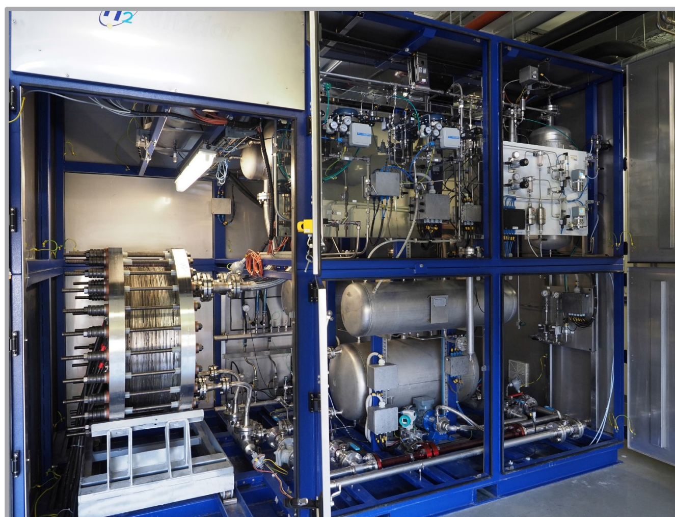
Abb. 2: Alkalischer Druckelektrolyse-Teststand mit 100 kW Block (links) Quelle: ZSW
